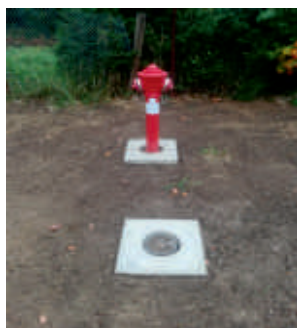
Sieć wodociągowa w Wapnicy
