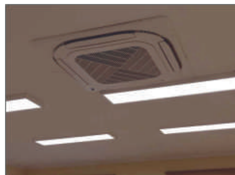
Klimatyzatory w świetlicy w StodkóWKu
